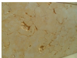
Scelta sbagliata del materiale usato in esterno
